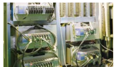
乾燥工程のPLC
