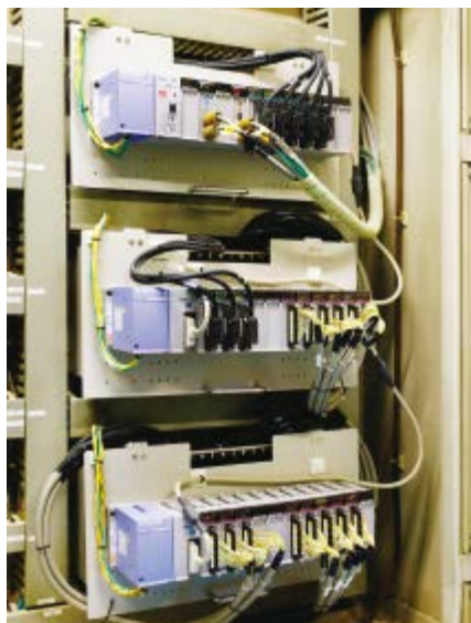
成形工程のPLC
