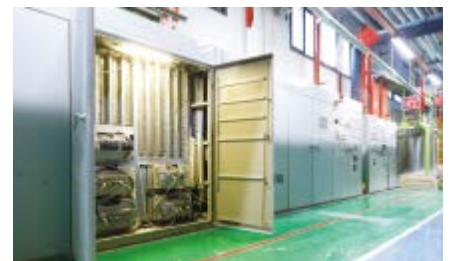
制御盤の中に設置されたPLC
