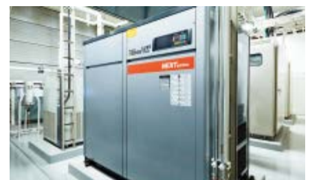
沼津工場には55kWタイプ日立製空気圧縮機を2台設置
