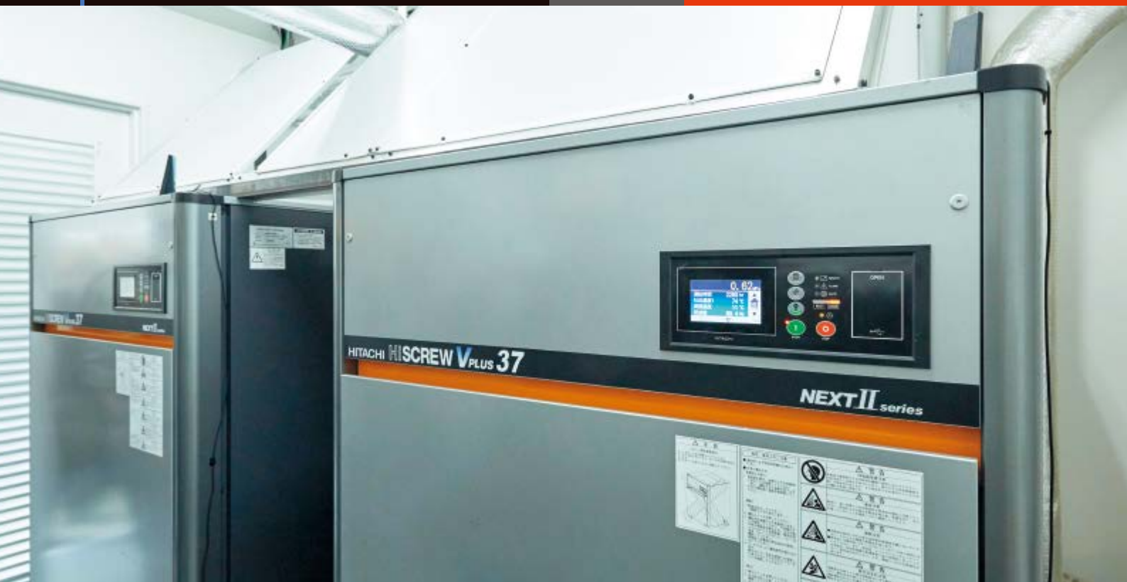
第三工場には37kWタイプの日立製圧縮機が2台設置。IoTクラウド監視機能が導入されている
