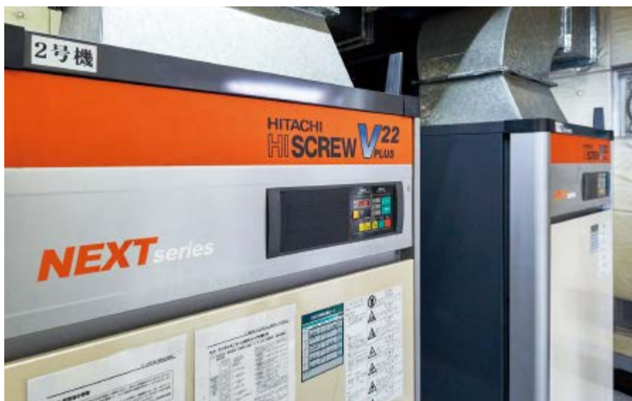
第二工場に設置された日立製圧縮機にもIoTクラウド監視機能が導入されている
