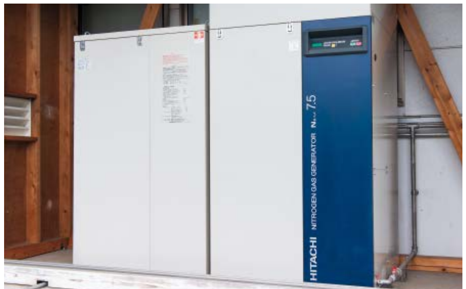
最初に導入された7.5kWタイプの日立製窒素ガス発生装置
