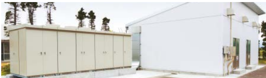
キュービクル(左)、制御室・蓄電池室(右)
