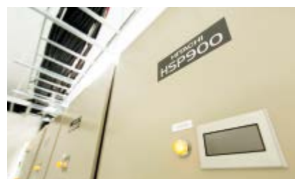
パワーコンディショナ(100kVA)
