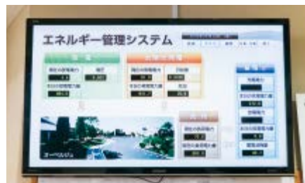
システムの運転状況を表示する館内モニター
