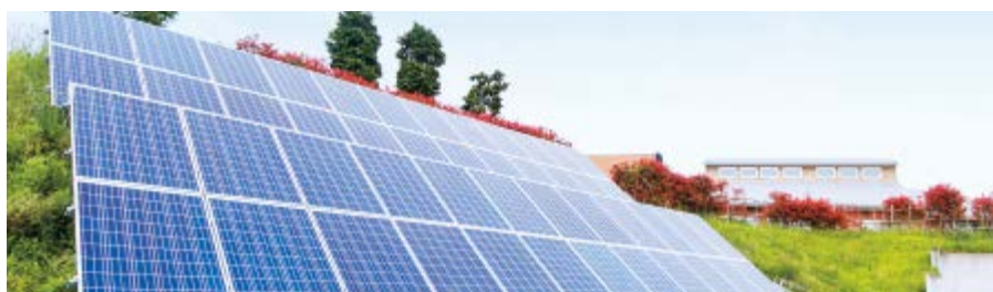
広大な施設内のいたるところに設置された太陽光パネル
