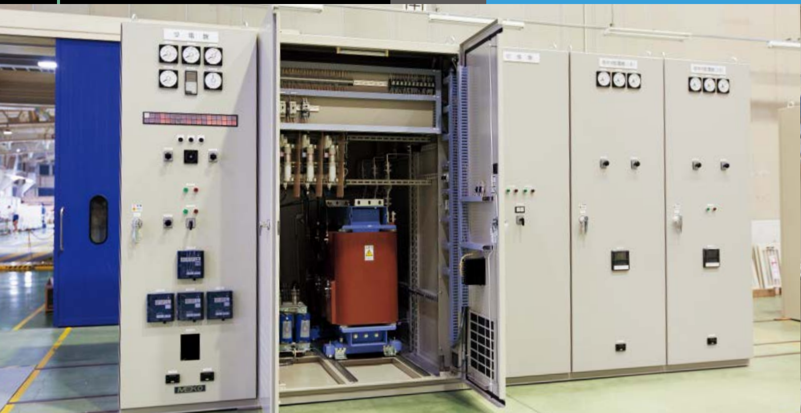
ダム施設用の受配電設備の配電盤には日立製のモールド変圧器が採用されている
