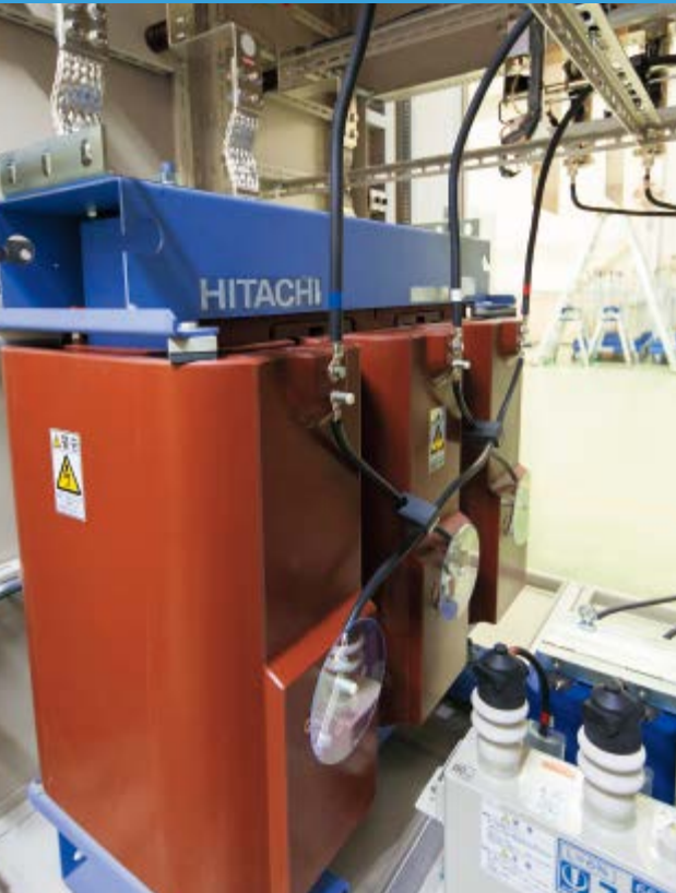
日立製モールド変圧器
