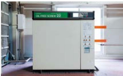
工場内の動力を担う日立製のコンプレッサー
