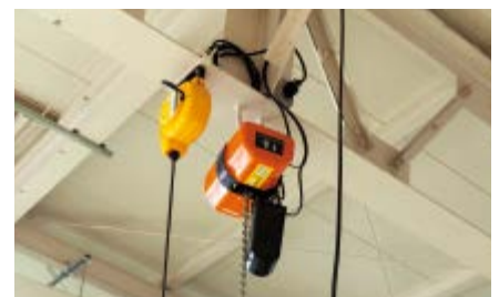
組立室の日立製モートルブロック
