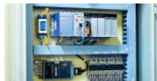
エネルギー監視システムインターフェイス盤
