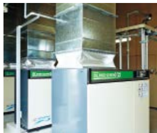
3台のコンプレッサーを台数制御
