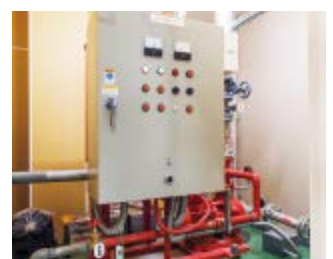
消火ポンプも日立製
