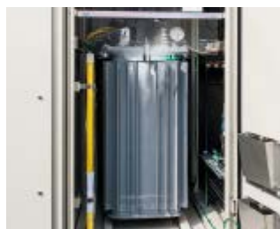
高効率のアモルフアス変圧器を導入
