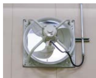
工場内の換気扇も日立製
