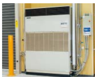
工場内に数台設置された日立の空調設備
