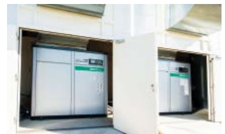
工場内のエア循環に欠かせないコンプレッサー
