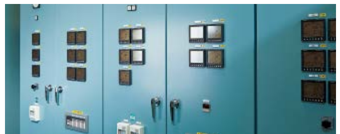
リプレイスされた配電盤
