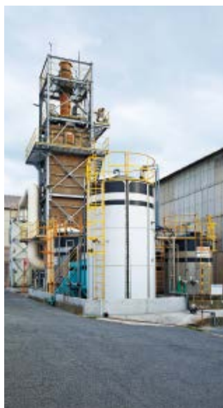
環境を守る排ガス処理設備
