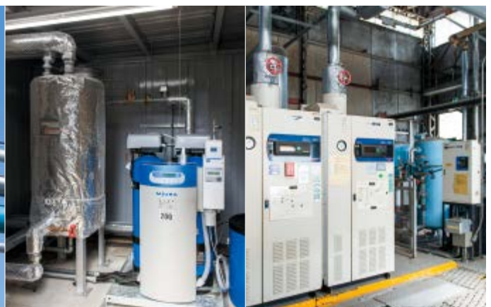
分散ボイラの軟水装置、ドレンタンク
