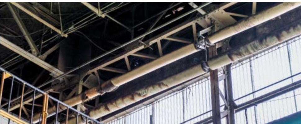
従来の蒸気配管
