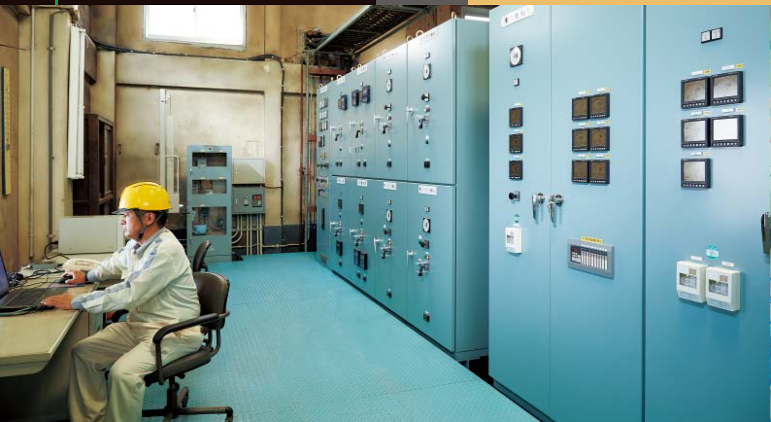
工場内の電力の使用状況をH-NETで監視
