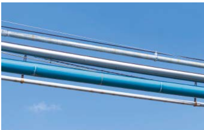
蒸気配管を細く短い配管に交換し、ロスを削減(上から2番目の配管)
