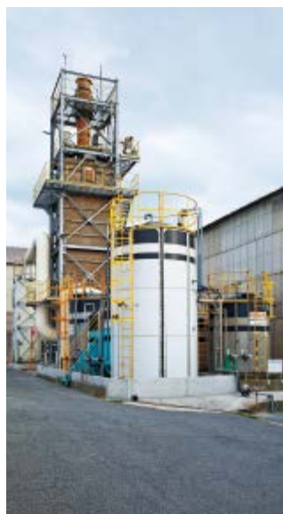
環境を守る排ガス処理設備
