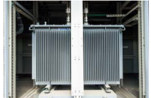
習志野事業所に導入した超高効率アモルファス変圧器
