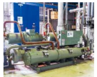
日立アプライアンス製のチラーユニット
