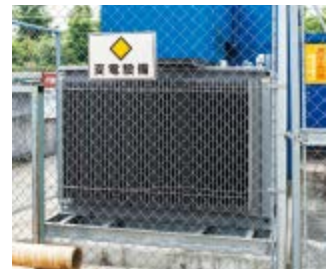
日立産機システム製の変圧器
