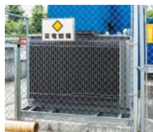
日立産機システム製の変圧器
