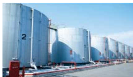
構内に整然と並ぶ絶縁油の貯蔵タンク
