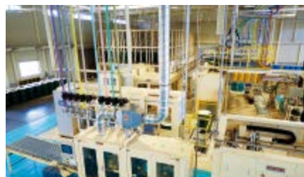
ドラム缶充填場。色分けされた配管は 品質管理とメンテナンス向上のため
