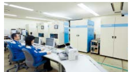
長年の経験とデータをもとにオリジナルで開発された 油中ガス自動分析装置で変圧器内部の異常を診断
