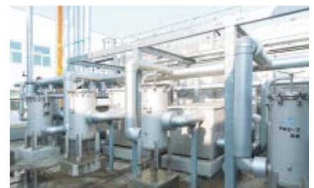
受水槽から水を汲み上げる日立製ポンプ
