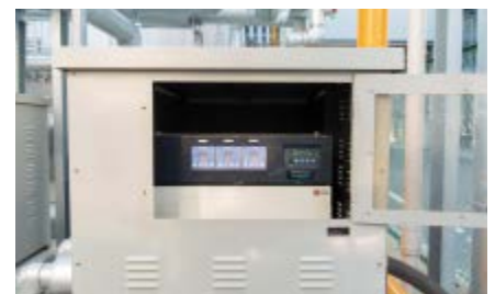
ポンプに組み込まれた日立製インバータ
