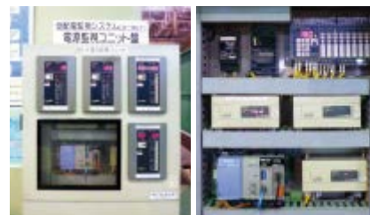
電源監視ユニット盤(左:外観 右:内部)
