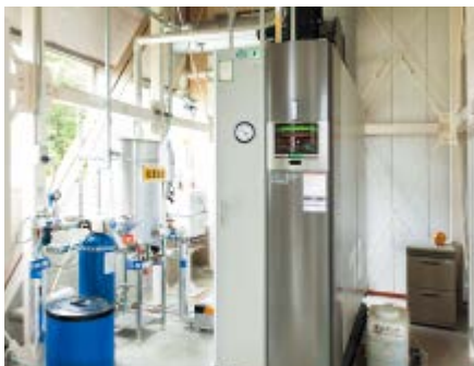
ボイラの分散配置による改善
