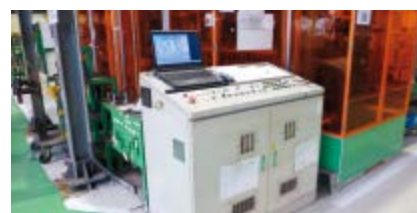
機械装置の前に設置された制御盤 (PLC)
