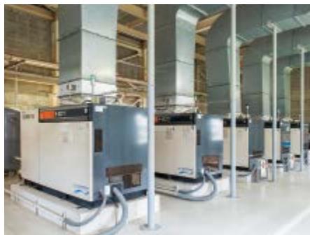
コンプレッサーの省エネ対策
