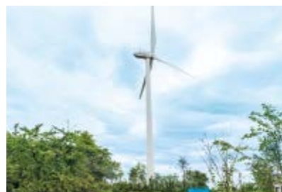
中条事業所構内の風力発電設備
