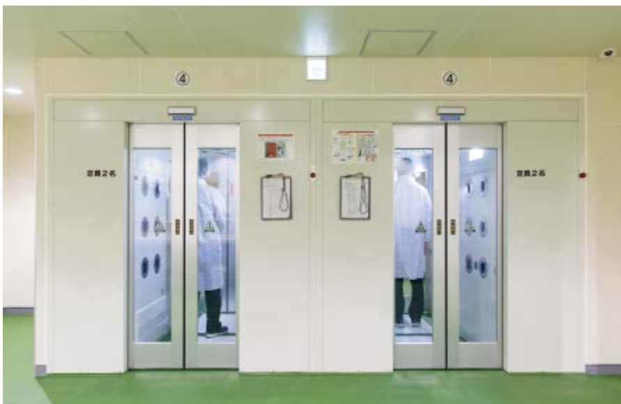
製造棟の入り口に設置されたエアシャワー
