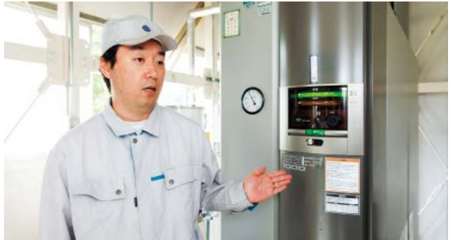
開閉器・エアクリーナ工場内に設置されたボイラ室
